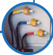
Barrajes de distribución
